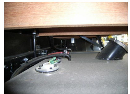
車両燃料タンクから電磁ポンプにより発電機へ自動供給（改造）
