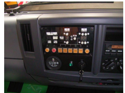
発電機 始動停止スイッチ（改造）
