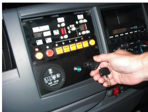
発電機スイッチON
