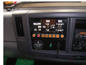
発電機 始動停止スイッチ(改造)
